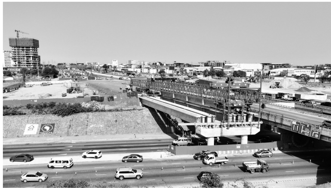
这是2026年3月15日在加纳首都阿克拉拍摄的由中铁五局加纳分公司承建的桥梁施工现场(无人机照片)。
