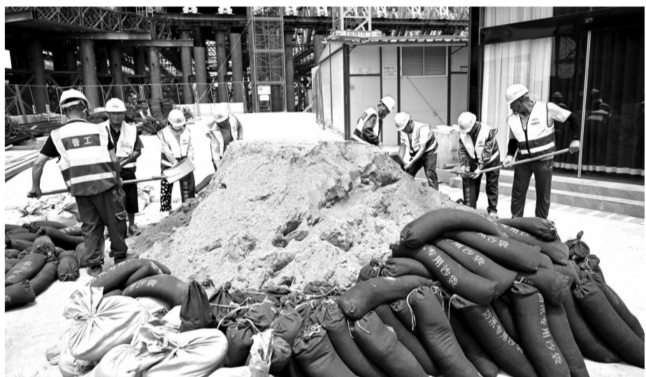
昨天,在嘉善县天凝镇的通苏嘉甬铁路三店塘大桥项目施工现场,工人正忙着灌装防汛沙袋,全力做好防台工作。 ■摄影 记者 冯玉坤
