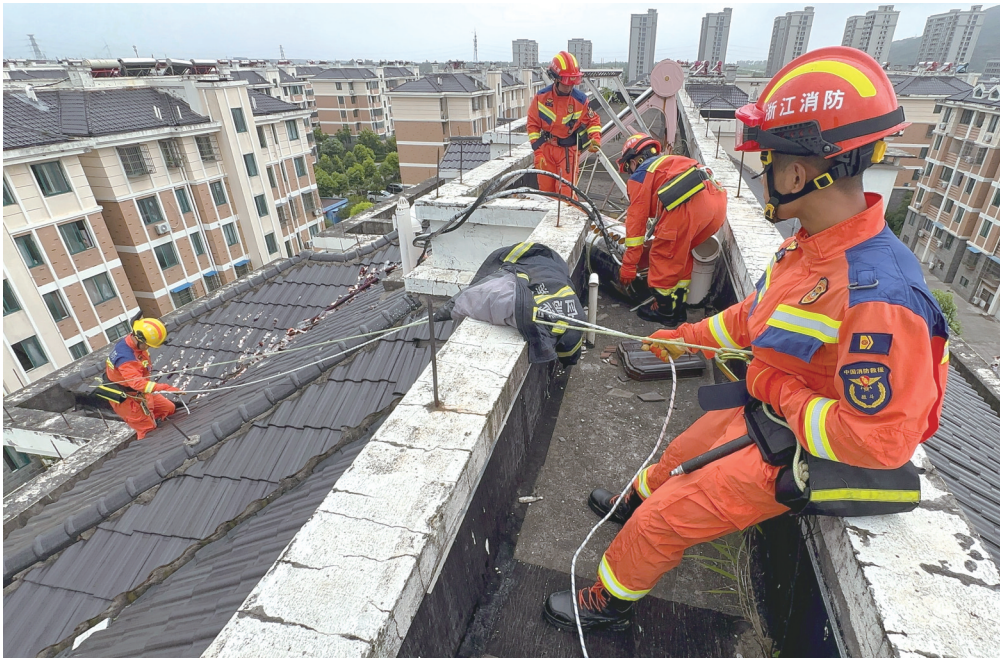
消防队员在抢险现场。
