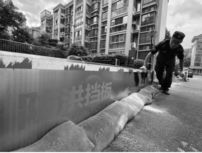
7月11日,南湖区东栅街道云阳社区紫竹名苑小区内,工作人员设置沙袋、围挡,阻挡雨水侵入地下车库。
